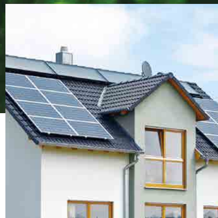
Fotovoltaické panely a invertery
